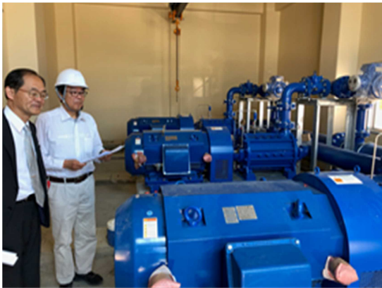
ディルアラ地区のポンプ施設
